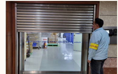
防火鐵捲門操作
