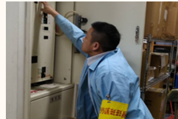
關閉火災當區總電源操作
