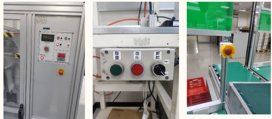
各式設備之緊急制動裝置（Emergency Stop Switch）
