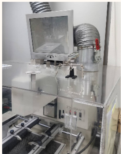
排風設備及定期檢查
